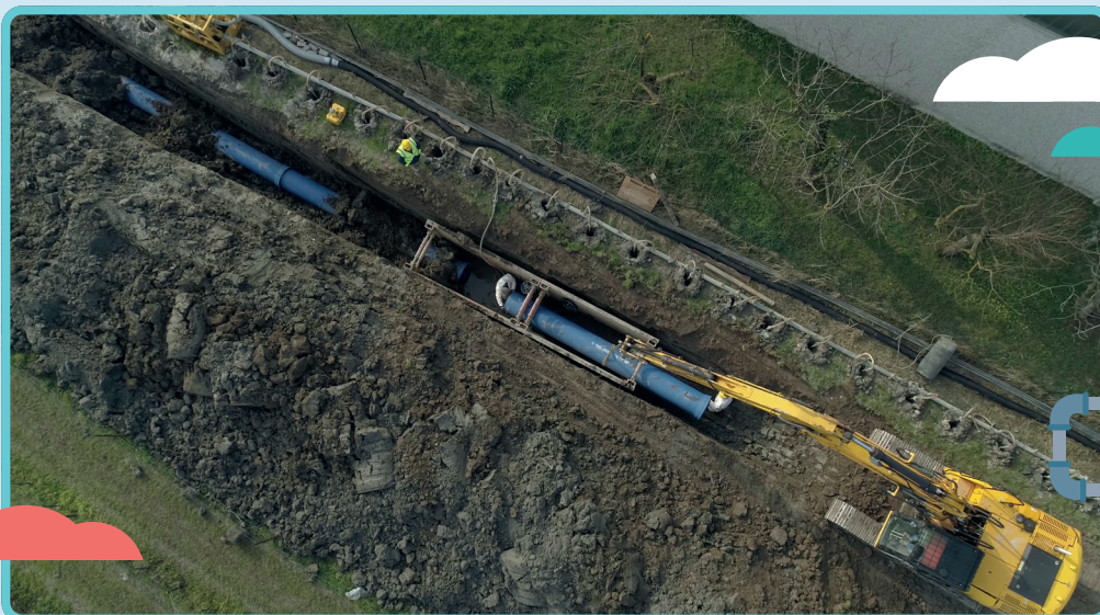
Posa della condotta adduttrice tra il nuovo campo pozzi di Belfiore e la centrale idrica di Madonna di Lonigo.
